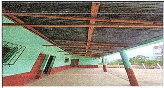
FOTO 4: ESTRUCTURA DE MADERA ANTIGUA Y DETERIORADA
