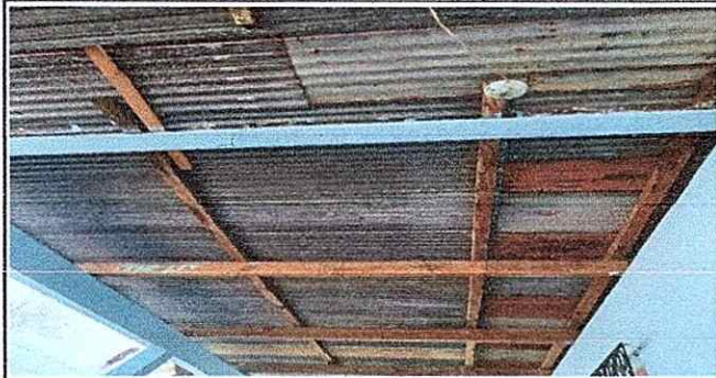
FOTO 1: LÁMINAS Y ESTRUCTURA DETERIORADAS
