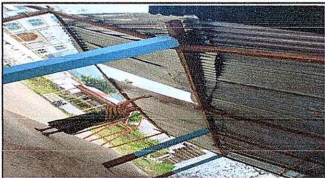
FOTO 3: POR REGLAS INVADIDAS POR LA POLILLA, LAS LÁMINAS YA NO SE SOSTIENEN CON LOS CLAVOS
